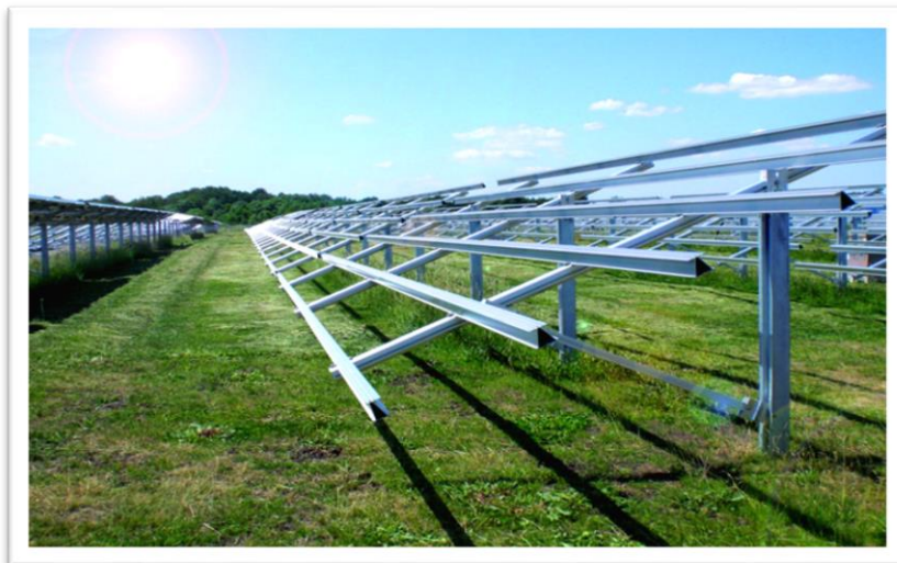
Konstrukcja - stoły pod panele fotowoltaiczne (wschód - zachód)
