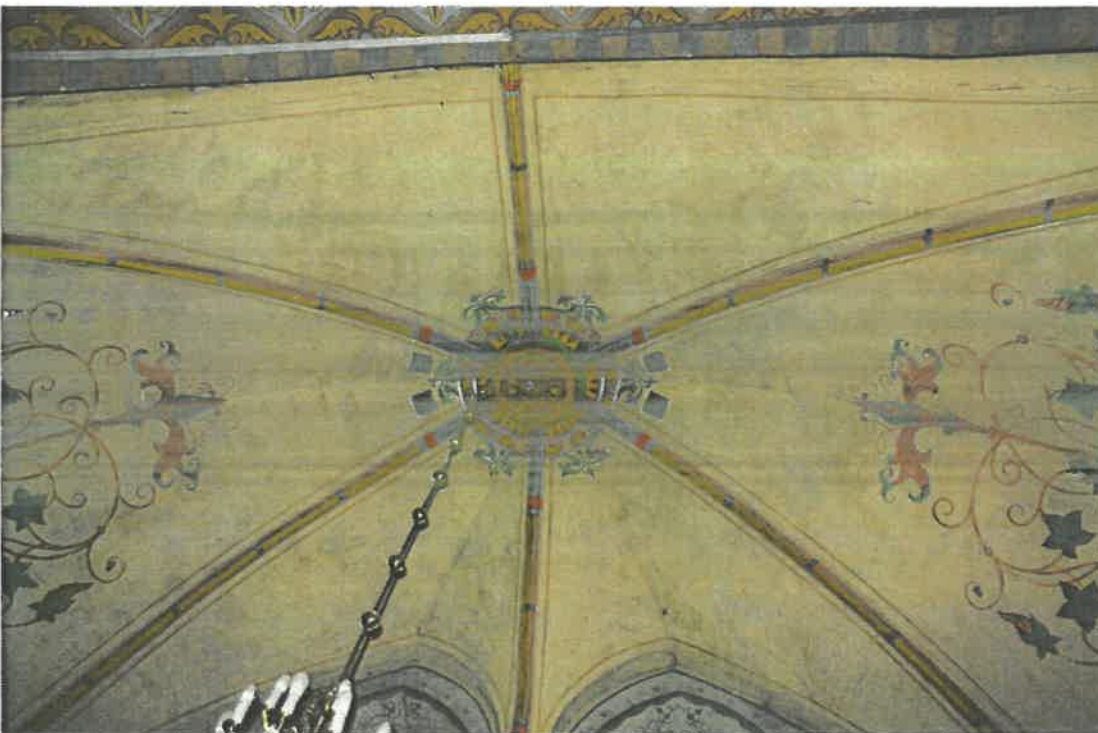
Fot. 7. Strożyska. Kościół p.w. Wniebowzięcia NMP. Sklepienie w kaplicy bocznej południowej. Widoczny obecny zły stan zachowania powierzchni polichromowanych. Widoczne przemalowania oryginalnej polichromii na sklepieniu. 2023 r.
