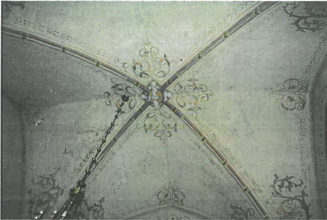
Fot. 6. Strożyska. Kościół p.w. Wniebowzięcia NMP. Sklepienie w nawie. Widoczny obecny zły stan zachowania powierzchni polichromowanych. Widoczna oryginalna polichromia na sklepieniu. 2023 r.
